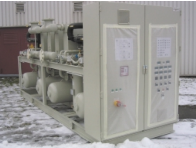
Die neue Anlage vor der Kältezentrale
