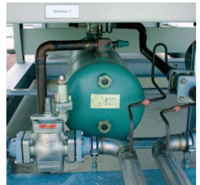
Kältemittelsammler mit Regelung und Druckaufnehmer für die Regelung der Verflüssiger-Ventilatoren.
