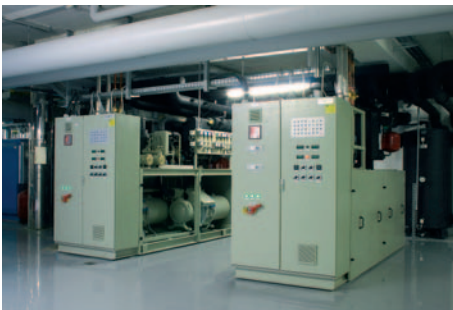
Eine Kältezentrale wie aus dem Lehrbuch.
