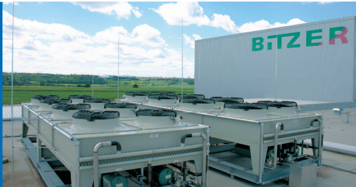
Luftgekühlte Direktverflüssiger der Baureihe GVH von Güntner auf dem Dach über der Kältezentrale des neuen Bitzer-Werkes in Rottenburg-Ergenzingen, ca. 20 km südlich von Sindelfingen.
